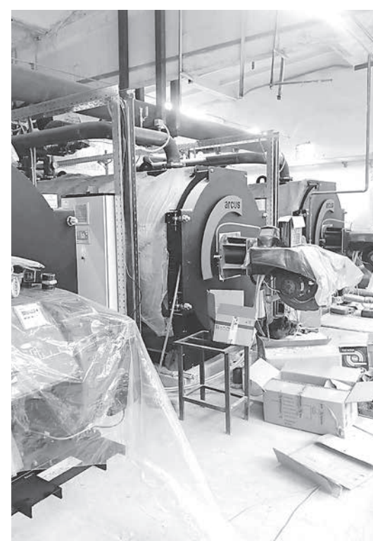
Новое оборудование установлено в котельной №7
